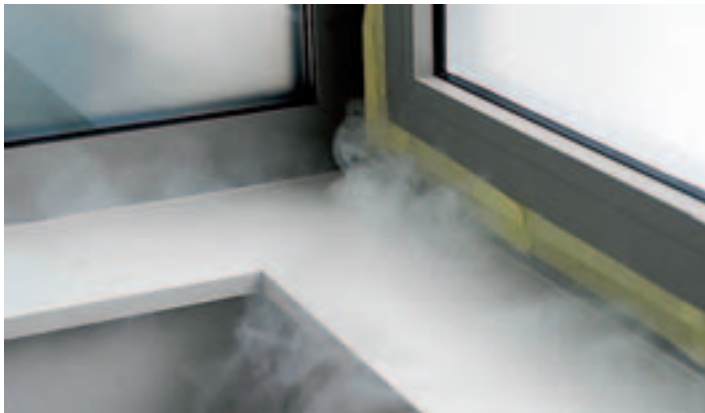
Le « blower door test » révèle de la fumée entrant par une des fenêtres. La fuite a été localisée. Le châssis sera remplacé... © ALAIN DEWEZ
